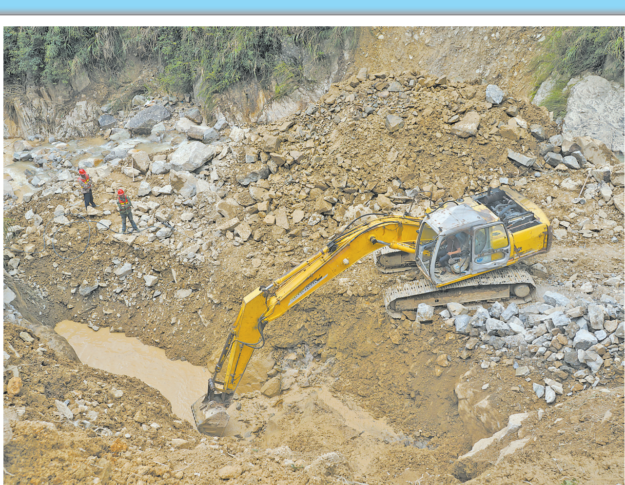
受台风“莫兰蒂”袭击,我市公路交通损毁严重。全市公路共计冲毁路基34公里,路面32公里,桥梁全毁2座,局部毁9座,涵洞损毁33道,崩塌934座。连日来,交通公路部门积极组织力量抢修抢通,图为9月21日,抢修人员正在省道304线上全力抢通。 本报记者 摄
