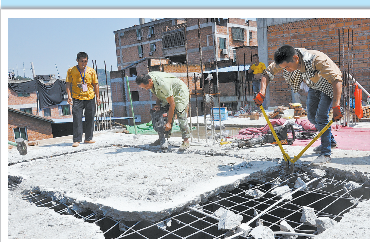
9月19日,东侨经济开发区治违办、漳湾镇治违办联合开展清违行动,对兰田村、马山村两座民房违建部分进行依法拆除,拆除面积近300平方米,有效震慑了抢建行为。
