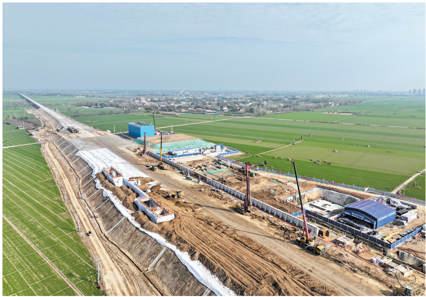
这是11月19日拍摄的位于河北省枣强县雄商高铁枣强南站建设现场(无人机照片)。
