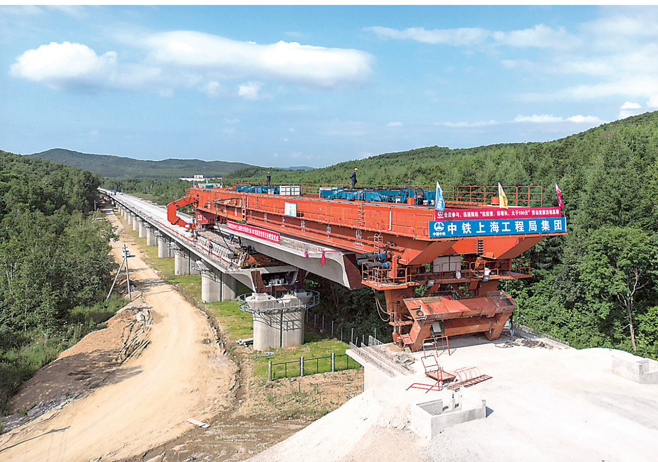
▲ 这是7月13日拍摄的黑龙省佳木斯市桦南县七峰林场3号特大桥梁架梁施工现场,工人正在进行喂梁作业(无人机照片)。 7月13日,由中铁上海工程局承建的牡(丹江)佳(木斯)客专吉丰村特大桥至七峰林场3号特大桥段完成架梁,标志着我国最东端高速铁路牡佳客专佳木斯段架梁施工完成。据悉,牡佳客专是国家“十三五”规划的重点铁路工程之一,工程全长371.6公里,设计时速250公里。 新华社发(张涛摄)
