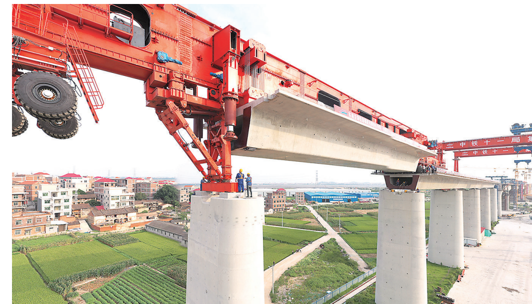
6月22日,在福厦高铁湄洲湾跨海大桥施工现场,高铁箱梁运架一体机在架设1000吨箱梁。当日,我国首台1000吨级高铁箱梁运架一体机在福厦高铁湄洲湾跨海大桥成功投入使用。1000吨级高铁箱梁运架一体机集提梁、运梁、架梁于一体,智能化程度高,可满足不同跨度的高铁箱梁施工作业。新华社发(金伟摄)
