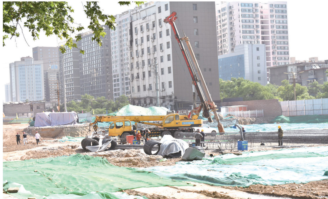
6月以来，我市各个建筑工地纷纷开展“安全生产月”活动，确保工程安全顺利推进。图为水塔游园建设项目工地内正在安全施工。 本报记者 杨全摄
